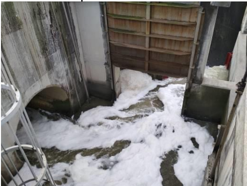
Foto 3: Saída do efluente tratado cara á comporta da cámara de carga
