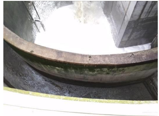
Foto 4: Detalle da canle pola que circularía o caudal de alivio en caso de pechar a comporta do emisario
